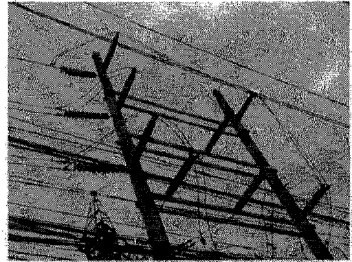
Visible Light Image SD-UG SAA 3YB-01 สถานีไฟฟ้าสามพราน 1
